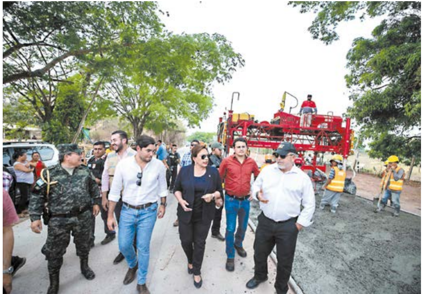
La Presidenta Xiomara Castro en compañía de los secretarios de Estado, Octavio Pineda de la SIT y Warren Ochoa del FHIS realizaron la supervisión de la construcción del tramo carretero en Talanga.
