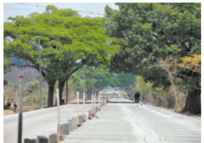
Los avances hasta el momento son significativos y se prevé que su construcción estará concluida para el año 2025.
