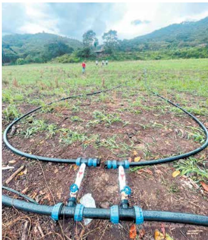
El material que se recuperó luego del abandono de la empresa ejecutora de este proyecto, está siendo utilizado para el nuevo proyecto de riego en Jamastrán que beneficiará a 1,000 productores.
