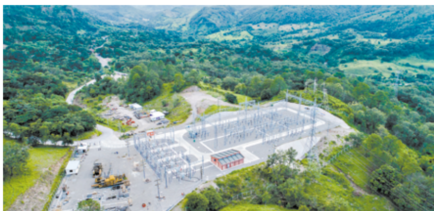
Subestación Calpules, en el sector de la Lima.
