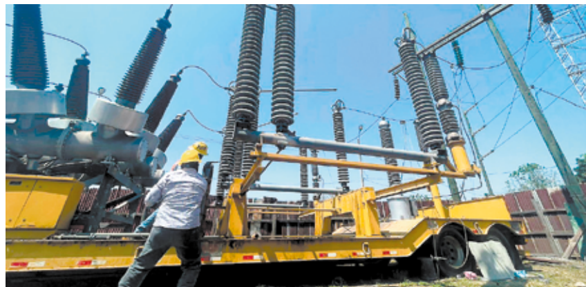
Subestación La Victoria, en el municipio de Choloma.
