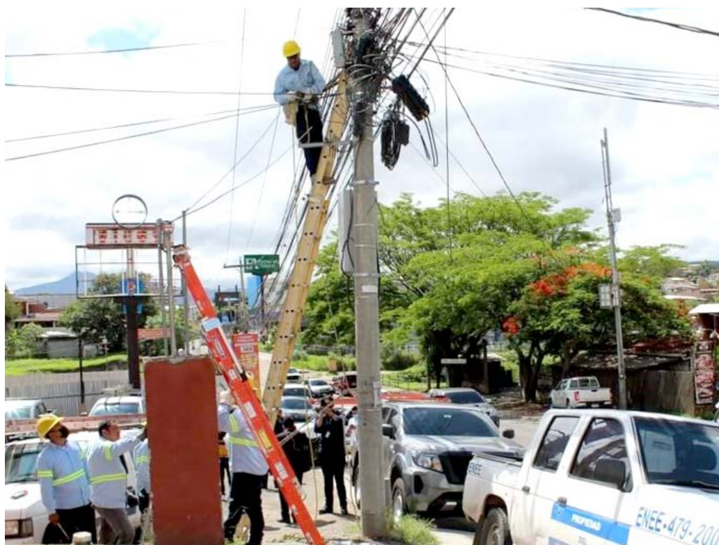
Las cuadrillas de la estatal eléctrica trabajan para resolver las pérdidas técnicas.
