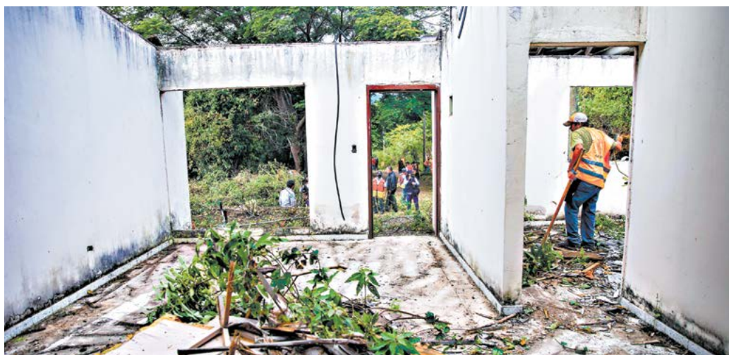
En esta imagen se puede ver el deterioro que han sufrido algunas viviendas.
