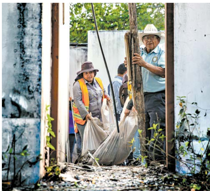
El personal de limpieza extrajo bultos de basura del interior de las construcciones.
